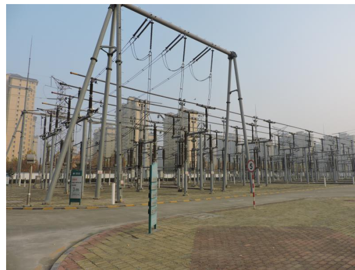
110kV 户外 AIS 配电装置
