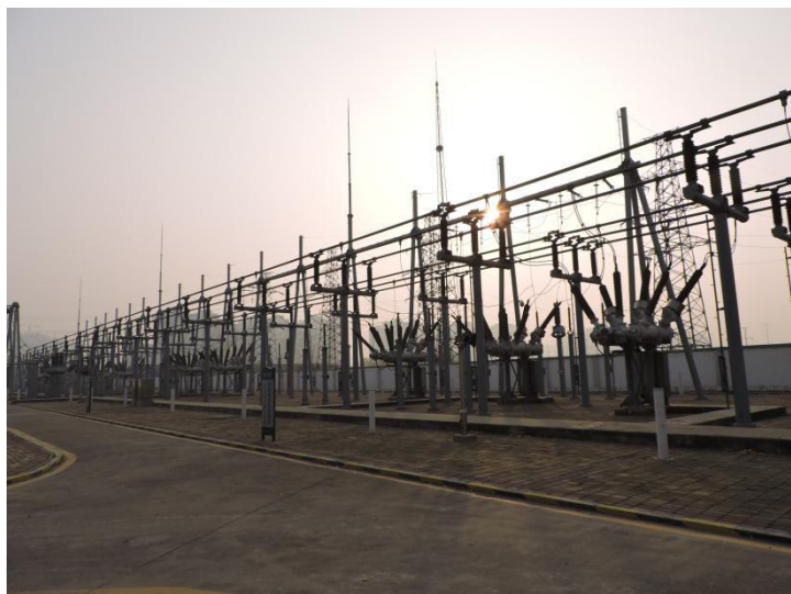
220kV 户外 AIS 配电装置
