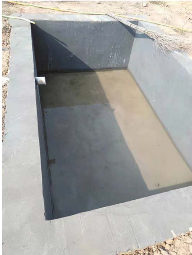
图 3.3-3 集水槽（收集淋溶雨水）
