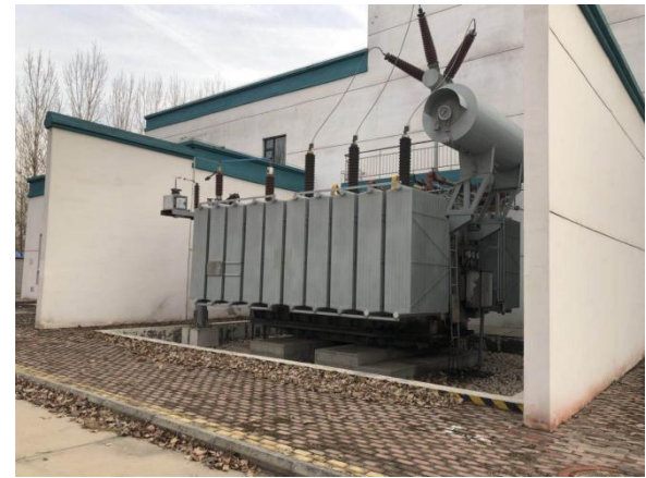
站址内现有 1#主变
