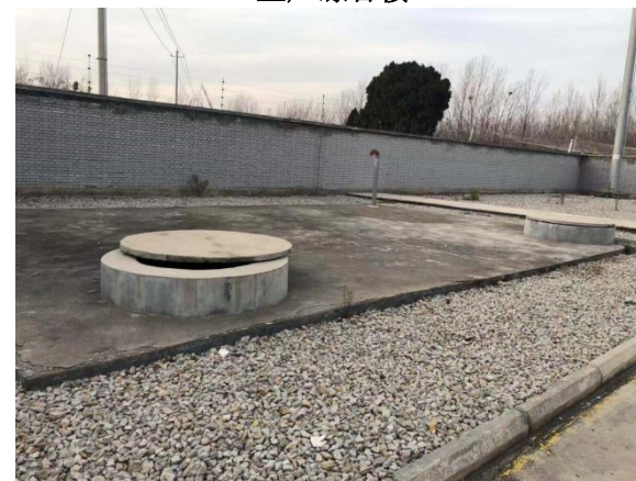
站内消防水池
