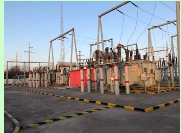
站址内主变现状
