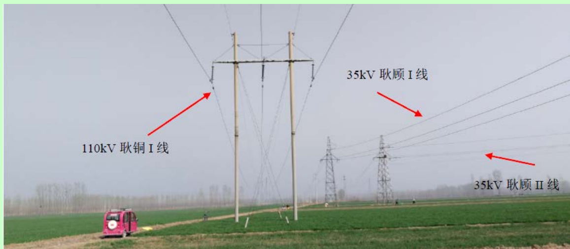
110kV 耿铜 I 线、需要跨越的 35kV 耿顾 I、II 线
