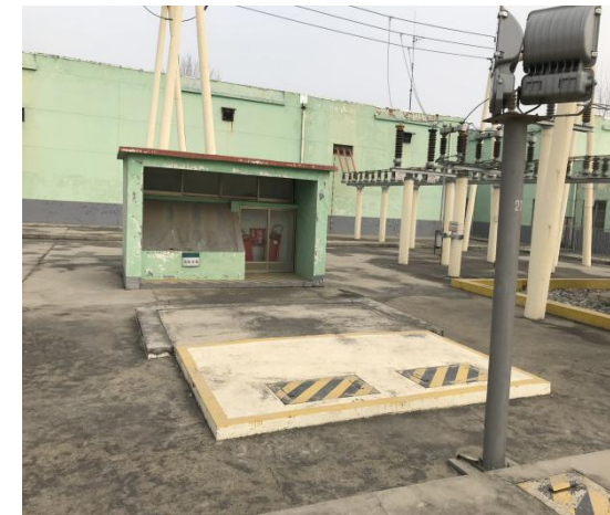
事故油池、消防亭
