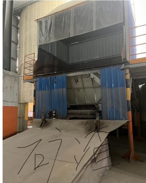
上料口规范化收尘设施
