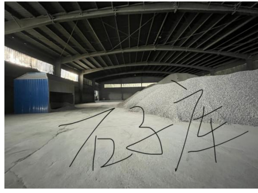
上料口规范化收尘设施
