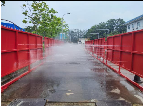
厂区出入口洗车台
